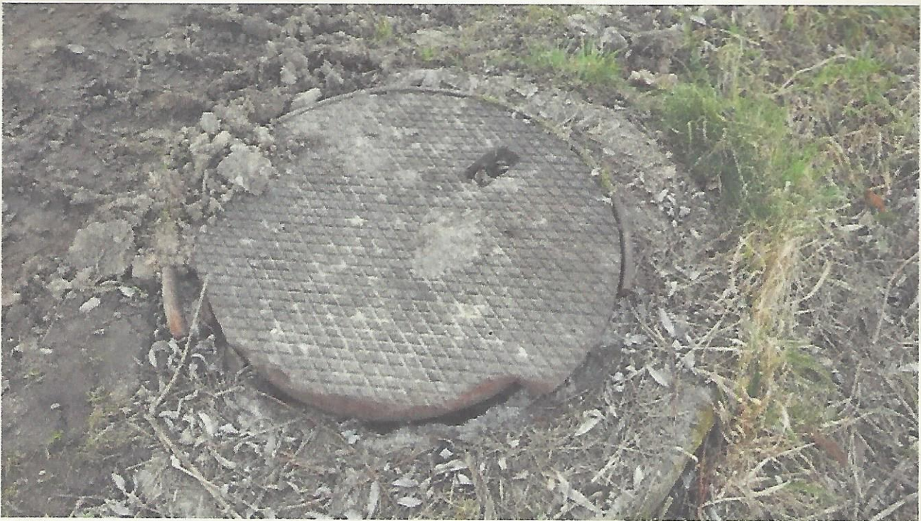
Abbildung 1: Abdeckung am Durchlass mit Spalt/Einschlupf für Tiere am 27.02.2021.
